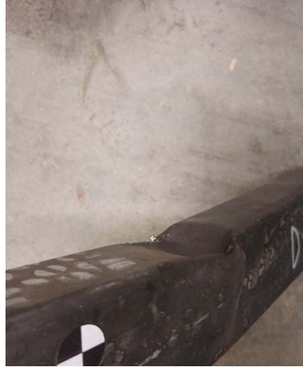
Şekil 47. Dikdörtgen kesitli İBÇE kirişte oluşan yerel burkulmalar
