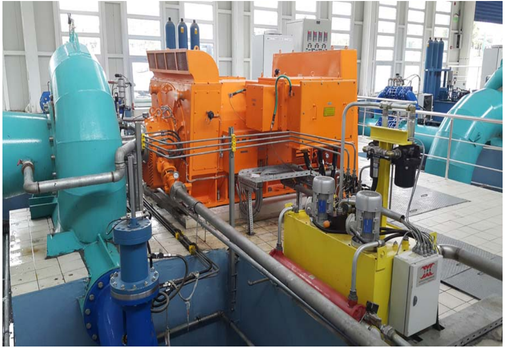
Şekil 1.7. Yuvacık HES'teki Asenkron Jeneratörler [13]
