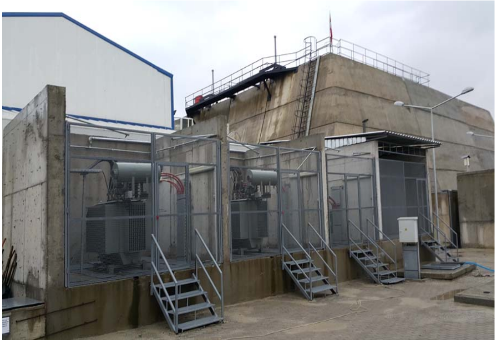
Şekil 1.5. Yuvacık HES'teki Elektrik İletim Panoları ve Trafolar [13]
