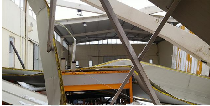
Şekil 1. İş yerinin çatısı çöktü[4, 2014].
