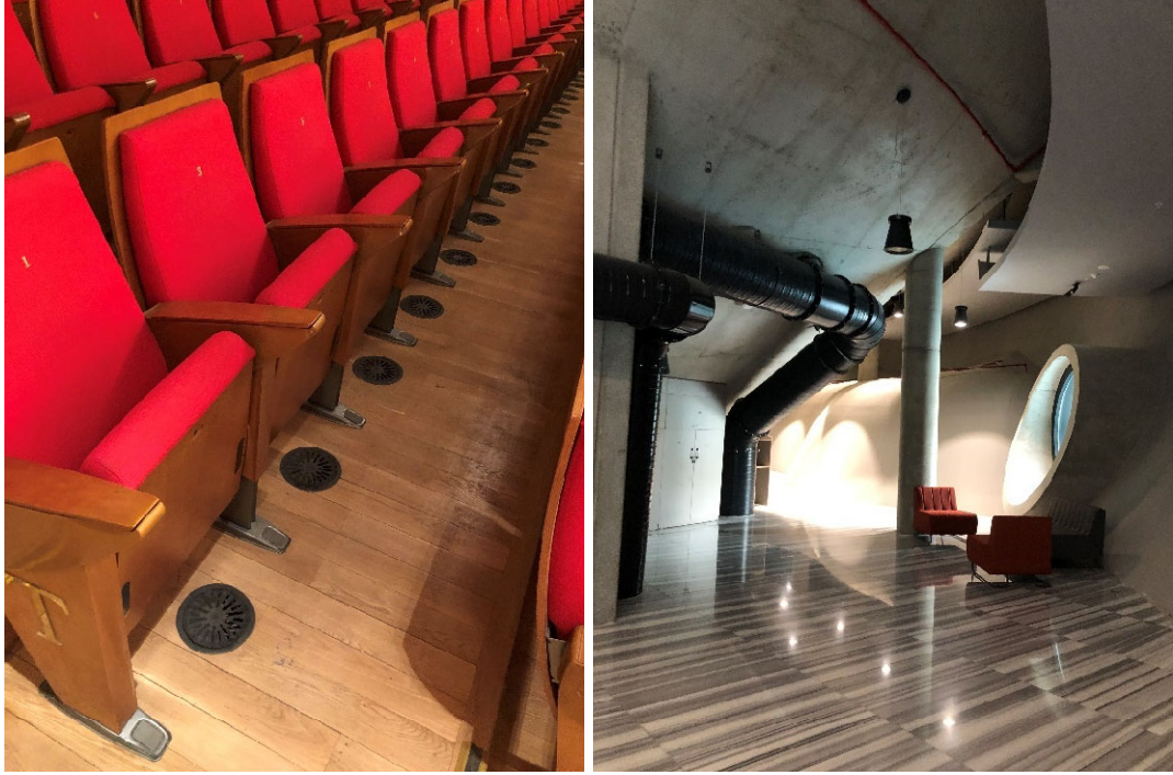
Şekil 15. Tarihi salon zeminden havalandırma (Solda), CSO Yeni Salon teknik birimlerden görülen havalandırma sistemi (Sağda)
