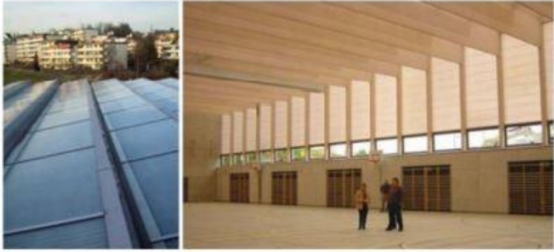
Şekil 31. Cabot aerojel granül dolgu Scobatherm cam elyafı kompozit panellerin şeffaf bir gün ışığı alan çatı konstrüksiyonu biçiminde kullanımının ilk örneği, Zürih'teki Buchwiesen okulunun jimnastik ve beden eğitimi salonundadır
